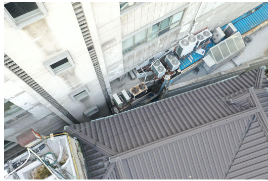
동방면 실외기 설치 현황
